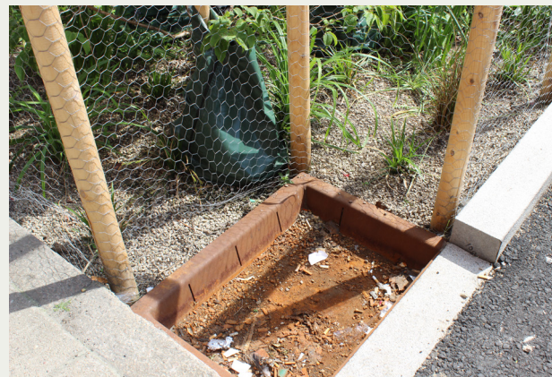
▲ Sandfångskar som ska rensas.
