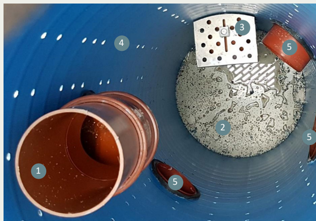
Insidan av styrbrunn. Brunnens väggar är perforerade för att vatten och luft ska kunna passera.
